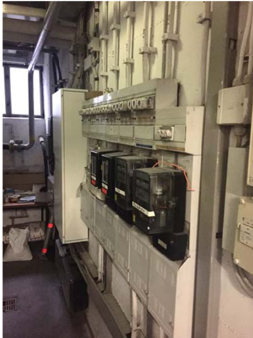
Kellergeschoss, Hausanschluss und Elektro- verteilung
