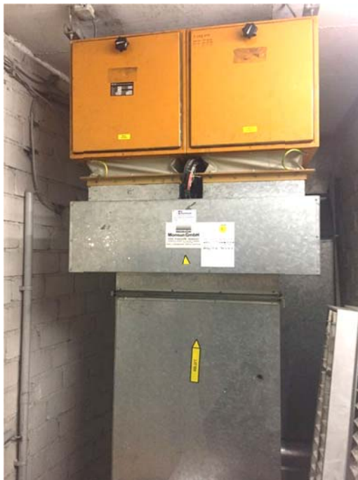
Kellergeschoss: Lüftungsanlage Tiefgarage
